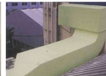
ダクトの放熱防止
